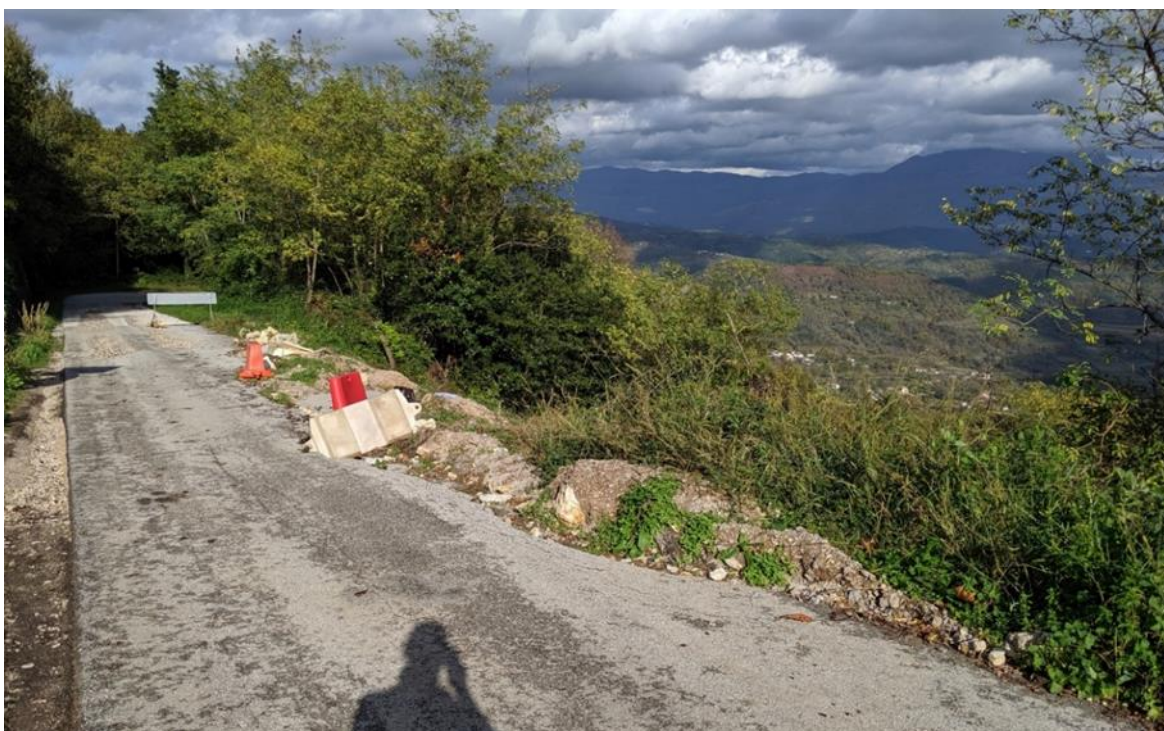
Slika 2.3. Fotografija oštećenja kolničke konstrukcije prometnice nastalog uslijed klizanja te krune klizišta, promatrane od JZ prema SI (fotografirano 4.11.2019).
