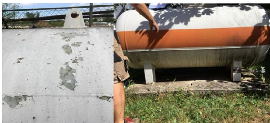
Slika 3-14. Oštećenja spremnika za ukapljeni naftni plin ( http://e-glasnik.tuv-croatia.hr/index.php/tehnicka-inspekcija/item/205-unp-spremnici )
