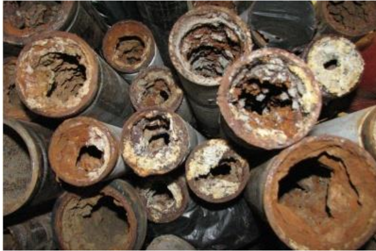
Slika 4-3. Unutarnja korozija cjevovoda (corrosionpedia.com, 17.8.2020.)
