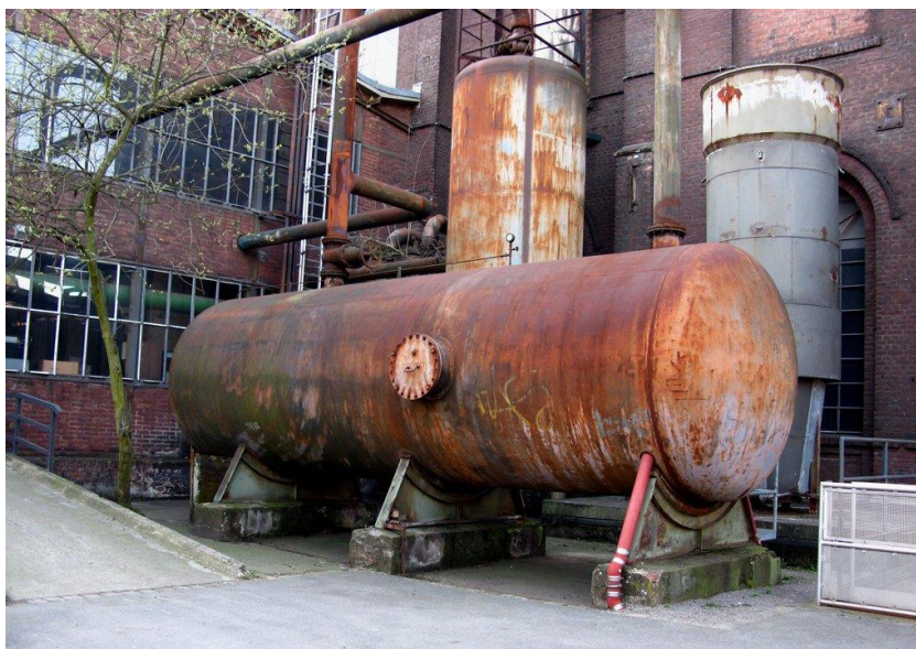
Slika 3-1. Primjer kemijske korozije ( https://www.shubbak.de/2014/03/21/corrosion/ , 08.09.2020.).
