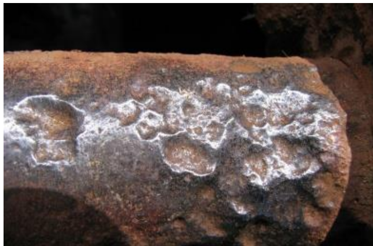
Slika 4-4. Vanjska korozija cjevovoda (corrosionpedia.com, 17.8.2020.)
