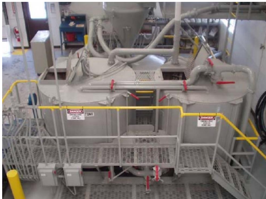
Slika 6-1. Postrojenje za pripremu cementne kaše izvan lokacije bušotine (Merritt, 2005)
