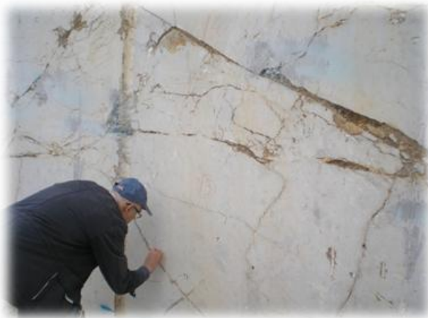
Slika 7.11. Snimanje pukotina zapadnog čela za izračun potrebnih količina MEYKO MP 364 Flex
