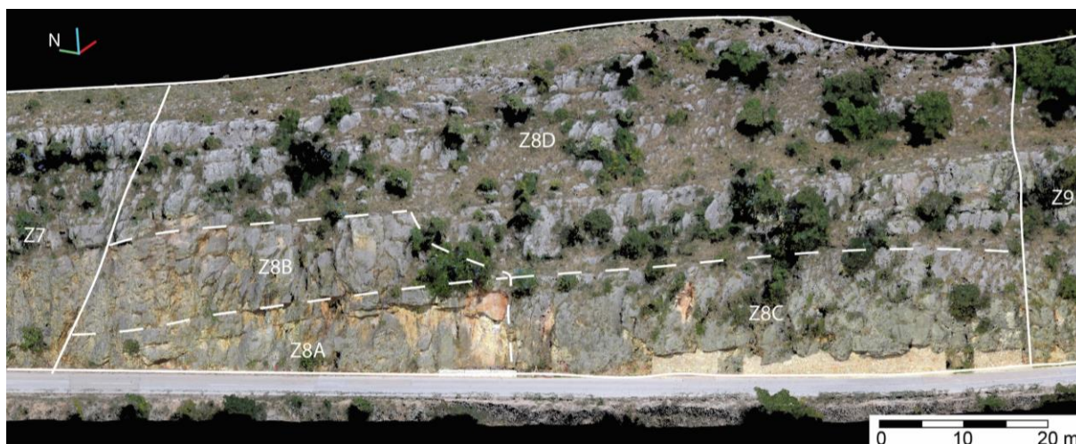
Slika 5.55. Pogled prema SI na inženjerskogeološke zone Z8A, Z8B, Z8C i Z8D s ucrtanim granicama zona na visoko-rezolucijskom digitalnom modelu istraživanih stijenskih kosina.
