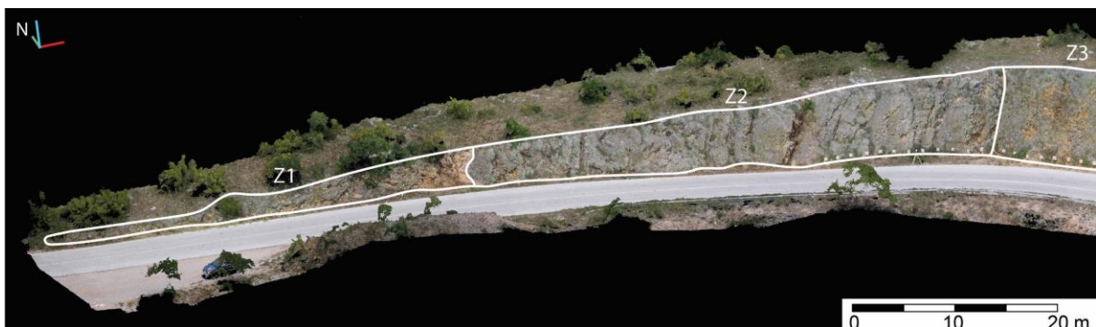
Slika 5.37. Pogled prema sjeveru na inženjerskogeološke zone Z1 i Z2 s ucrtanim granicama na visokorezolucijskom digitalnom modelu istraživanih stijenskih kosina.
