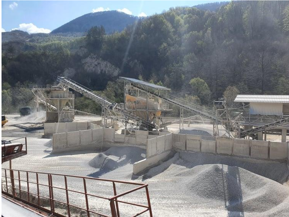
Slika 3.21. Oplemenjivačko postrojenje na radilištu LOVNO 2
