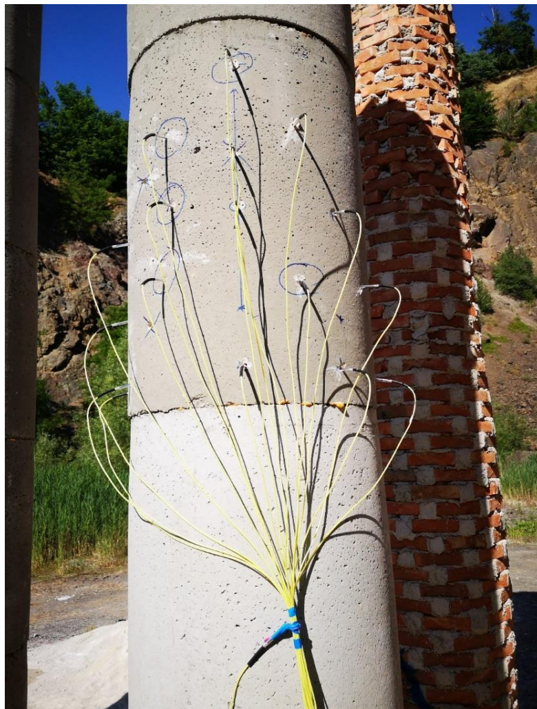
Slika 8-6 Prikaz sustava iniciranja gornjeg zaloma kod betonskog dimnjaka rušenog u dvije faze
