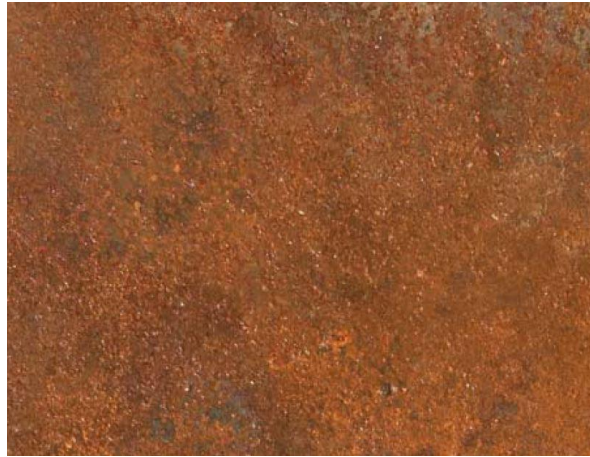
Slika 2-4. Primjer jednolike korozije (Bhardwaj, 2020.)
