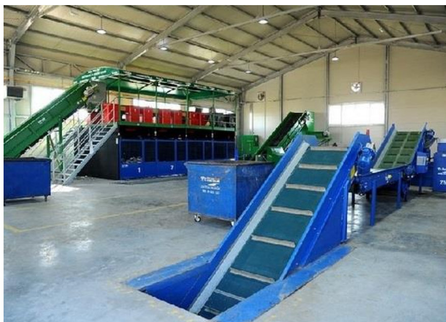
Slika 5-2. Sortirnica korisnog otpada u sklopu reciklažnog dvorišta u Prelogu (GKP PRE-KOM d.o.o., 2021)
