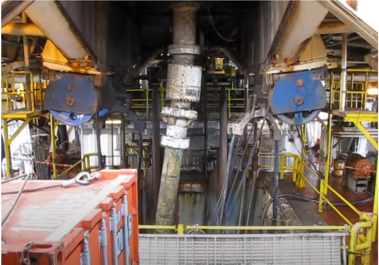
Slika 2-3. Gornja kuglasta spojnice (engl. diverter flexible joint ) na bušaćem brodu ( https://www.youtube.com , 2009)
