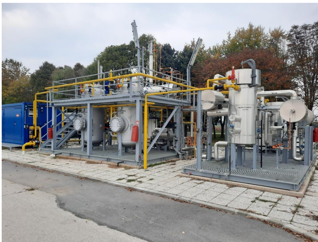
Slika 4-1. Postrojenje za obradu kaptažnog plina na MOS
