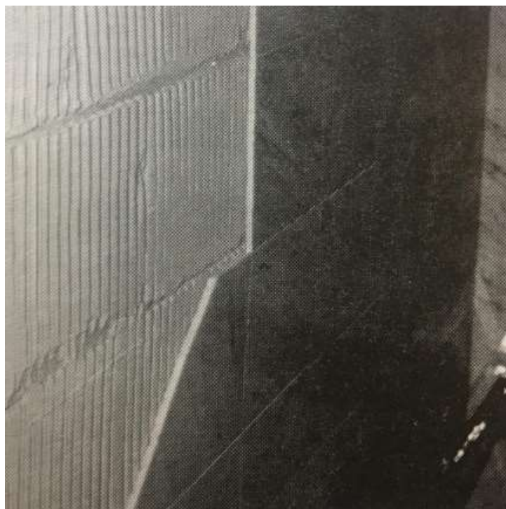
Slika 6-3 Otpadanje marmeta uslijed slijeganja zgrade Croatia Linea (preuzeto iz Crnković i Šarić, 2003)
