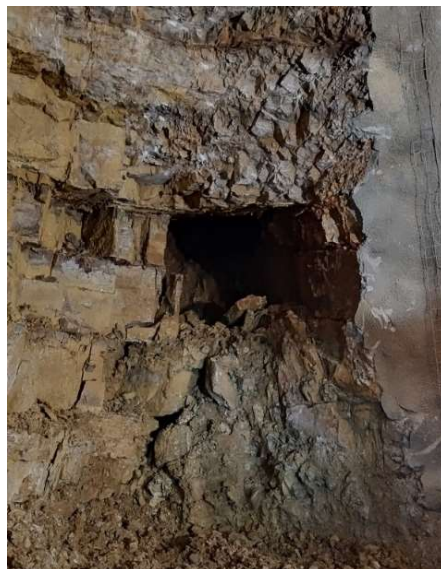
Slika 7-7. Kaverna između slojnih ploha 330/10-15 u desnom boku na stacionaži 30+667,50
