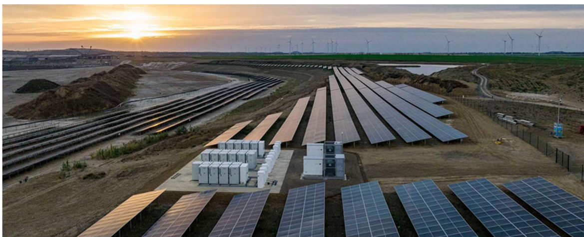
Slika 4-10. RWE sunčana elektrana Indeland Inden, Njemačka (RWE, 2024)
