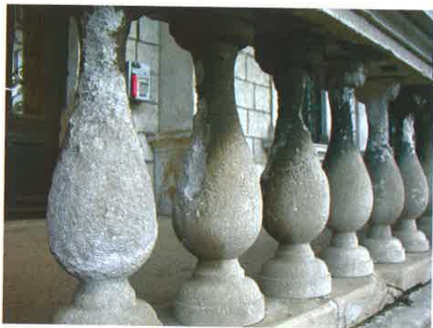
Sl. 8: Vila Eliza (Ekonomski fakultet u Dubrovniku). Oštećene, betonom obnovljene, te ponovno oštećene kolonade. U donjem dijelu vidljiv je potpuno neoštećeni kamen (2007.g.)
