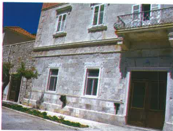
Sl. 2. Dački dom u Pučišćima. Prikaz neoštećenih natkrivenih i oštećenih natkrivenih dijelova fasade (2006. g.)
