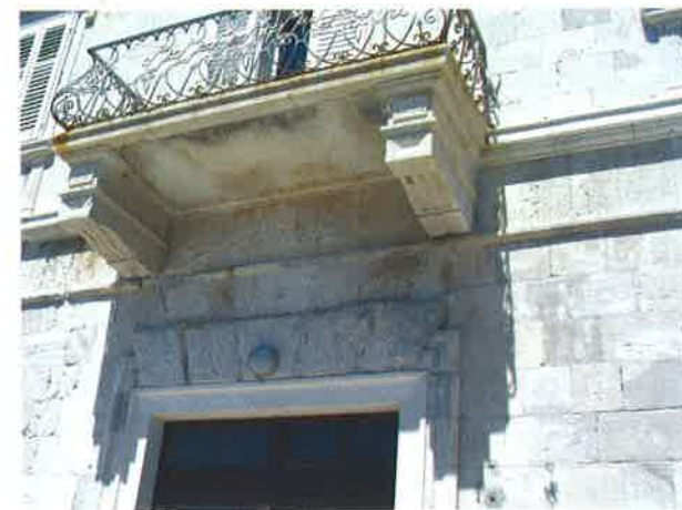
Sl. 7. Đački dom u Pučišćima. Velika oštećenja ispod balkona. (2005.g.)
