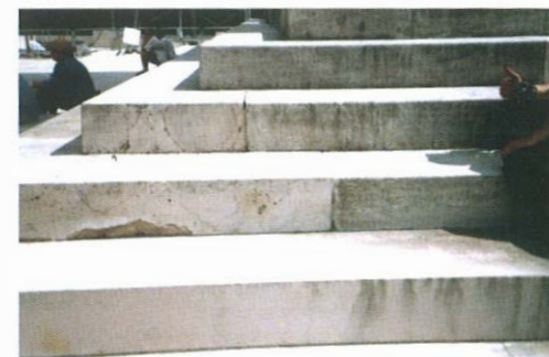
Oštećenja na stepenicama
