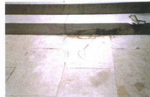
Oštećenja kamenih ploča na pješačkoj stazi do spomenika
