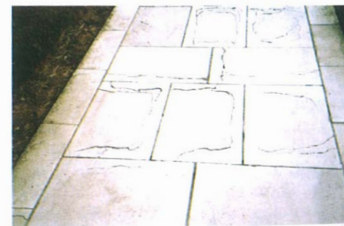
Oštećenja na kamenom postolju
