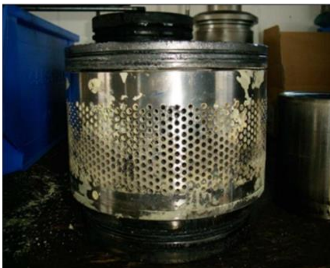
Slika 6-3. Nakupljanje sumpora na sigurnosnom ventilu (Marcogaz, 2022).
