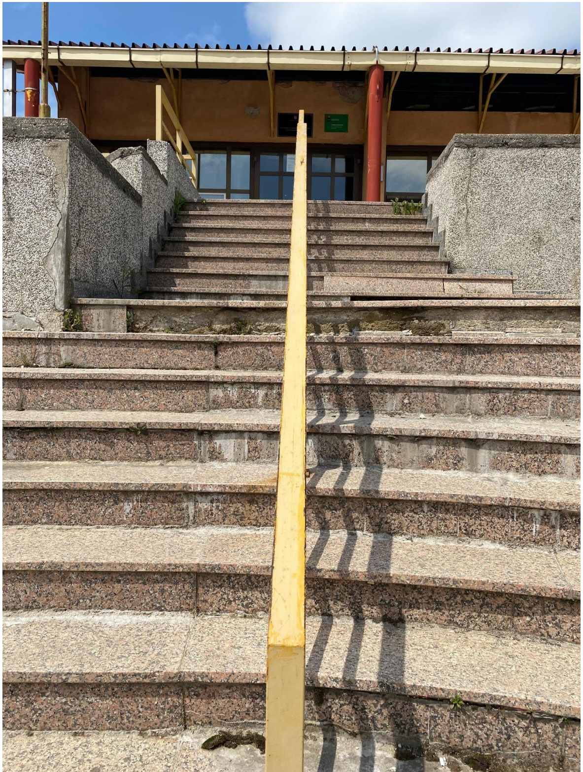
Slika 3-6 Prednji pogled na stepenice sportske dvorane Sveti Ivan Zelina. Na granitu s ružičastim alkalijskim feldspatima vidljivo je iscvtavanje soli i mehanička oštećenja.
