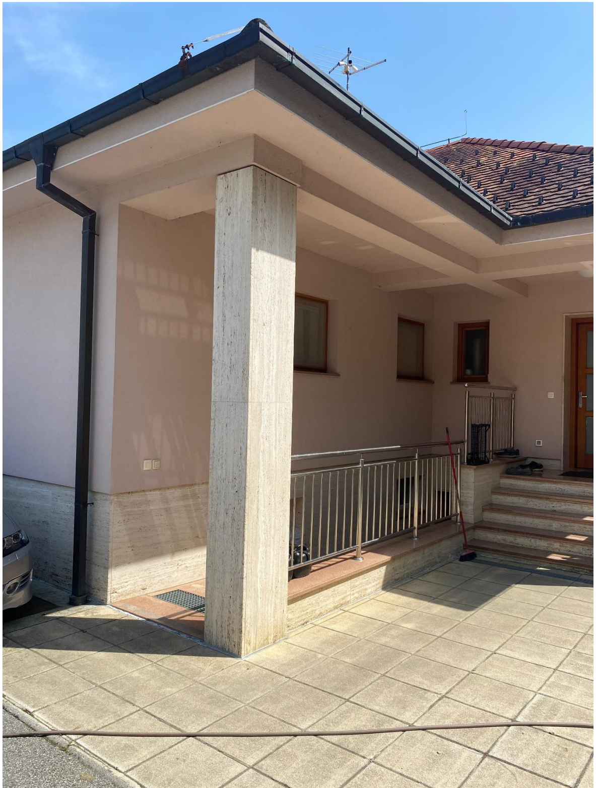
Slika 3-20 Prednji pogled na stup obložen travertinom, u sklopu stambene kuće u naselju Goričica, s vidljivom zonom kapilarnog upijanja.
