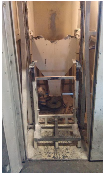
Slika 3-6. Automatski podizač spremnika u uređaj za recikliranje
