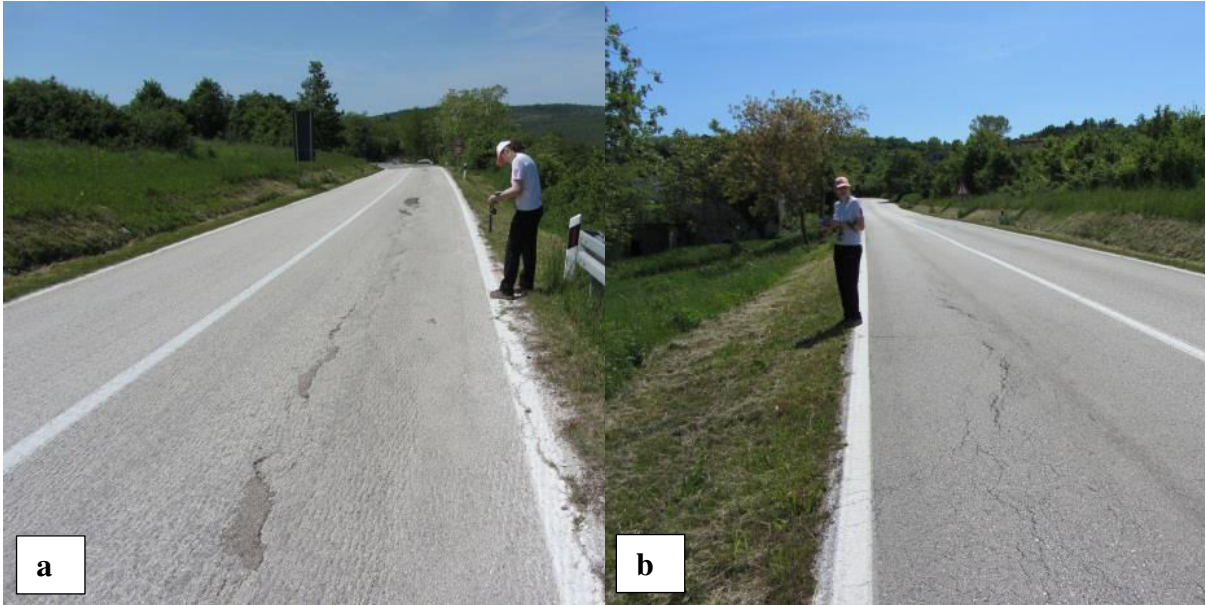
Slika 3.7. Pukotine na cesti ŽC 5209 koje ukazuju na klizanje unutar nasipa (snimio M. Krkač 8.5.2015.): (a) pukotina na stacionaži od 0 + 000,00 do 0 + 060,00; (b) pukotina na stacionaži 0 + 200,00.
