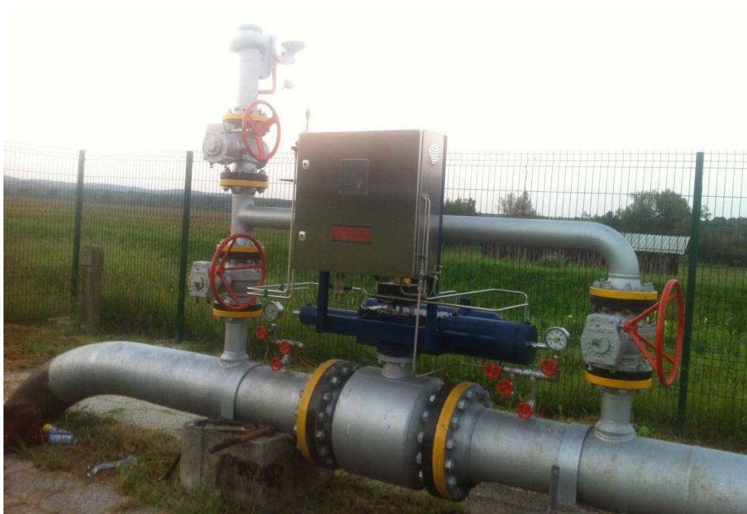
Slika 8-3. Blokadno-ispuhivačka stanica Čazma
