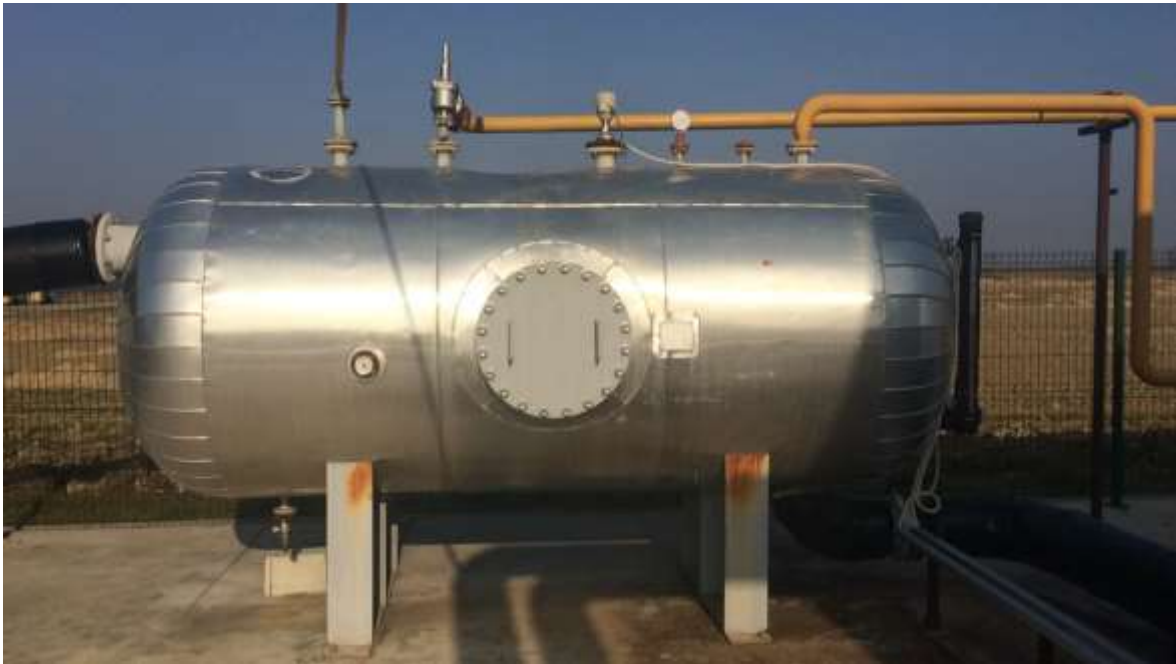
Slika 4-6. Separator plina i vode
