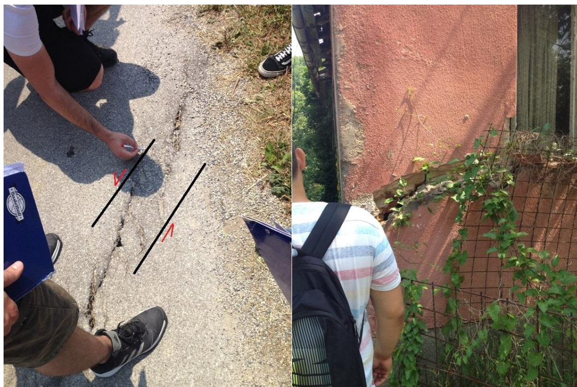
Slika 3.1. Oštećenja kao pokazatelji utjecaja klizišta Kostanjek (lijevo: vlačna pukotina na asfaltiranoj javnoj prometnici; desno: šteta na privatnom vlasništvu).
