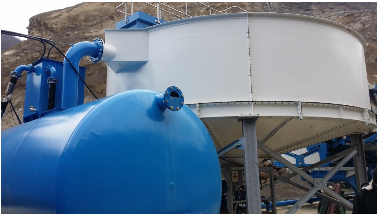
Slika 3-10. Sedimentacijski bazen i spremnik obrađene tehnološke vode
