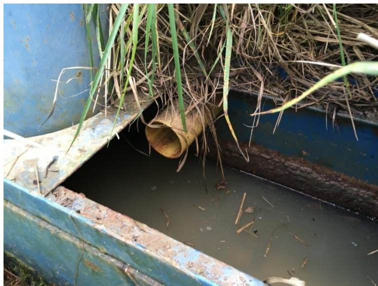
Slika 3.7. Izljev vode iz drenažne cijevi u melioracijski kanal (foto: Al Ahmed, 2016).
