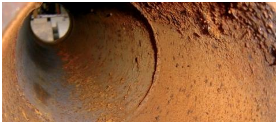
Slika 2-3. Opća korozija u cjevovodu (Minero, C. 2011, Laboratorio de Corrosao e Protecao – LCP)
