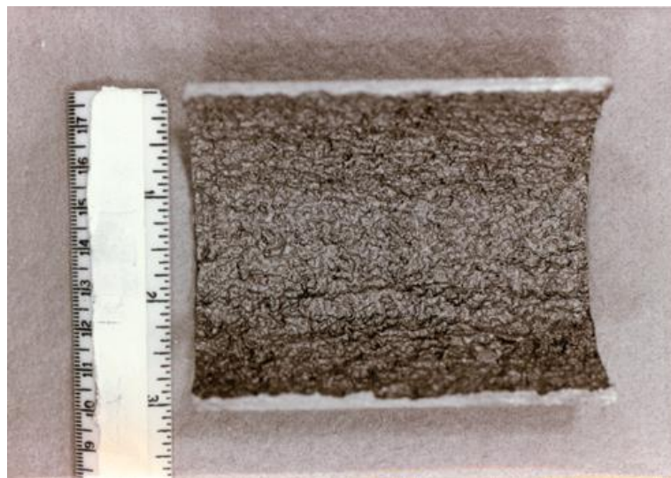
Slika 4-2. Rupičasta korozija (Pipeliner Indonesia, 2016)
