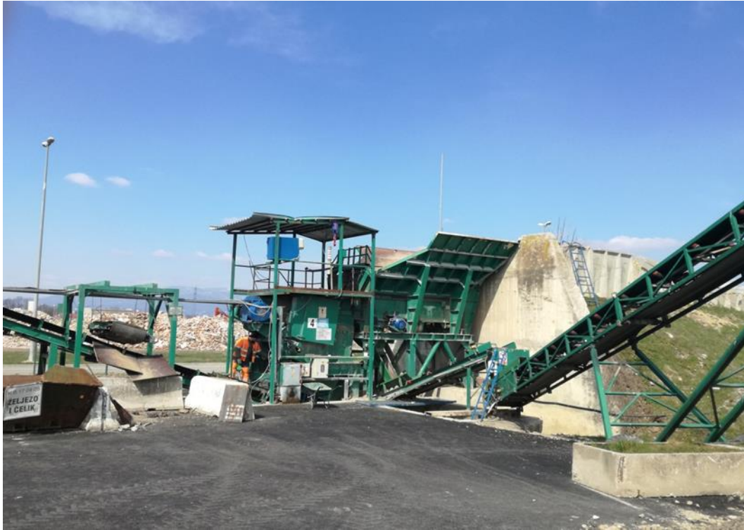
Slika 3-2. Prihvatni bunker i čeljusna drobilica.
