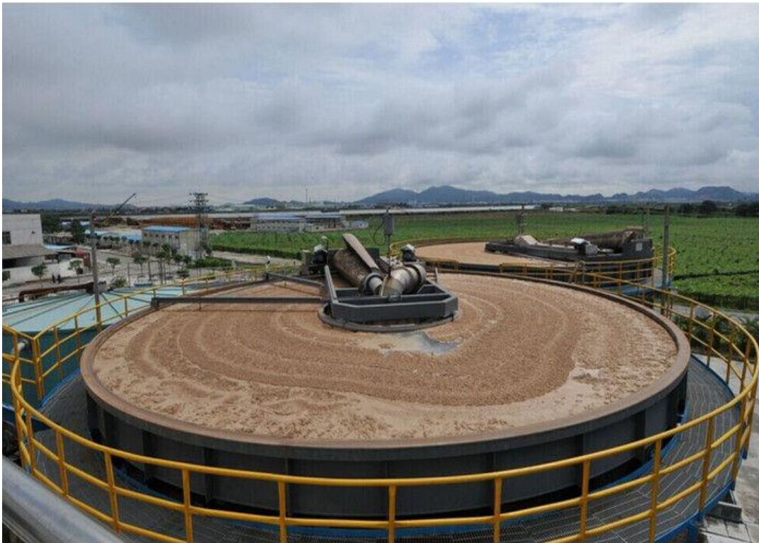
Slika 2-6 Flotacija (Seawater ro plant, 2018)
