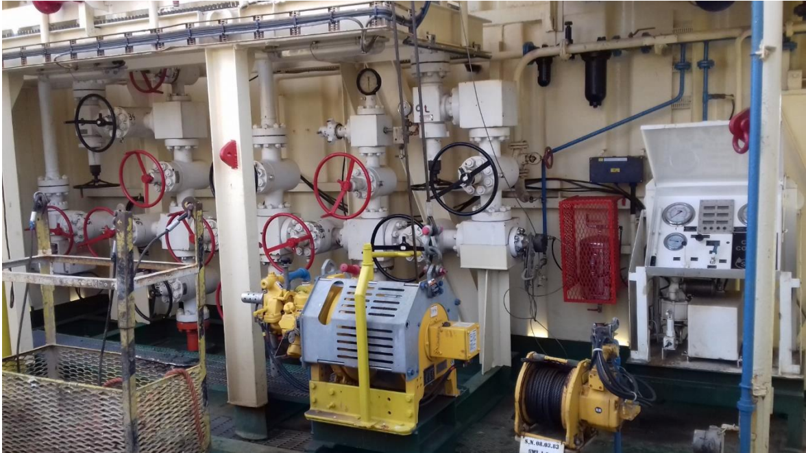
Slika 4-5. Razdjelnik podesive sapnice za odobalno postrojenje Labin (Fotodokumentacija tvrtke Croscio d.o.o.)
