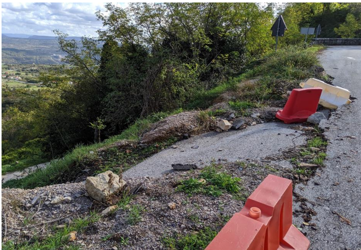
Slika 3.2. Prikaz oštećenja prometnice uslijed klizanja, promatrane od SI prema JZ (fotografirano 4.11.2019).
