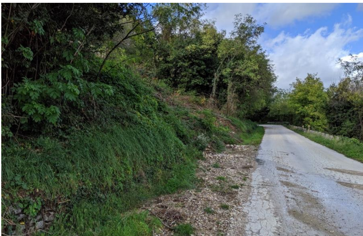
Slika 2.4. Fotografija oštećenja obložnog zida drenažnog kanala nastalog uslijed klizanja te nožice klizišta, promatrane od J prema S (fotografirano 4.11.2019).
