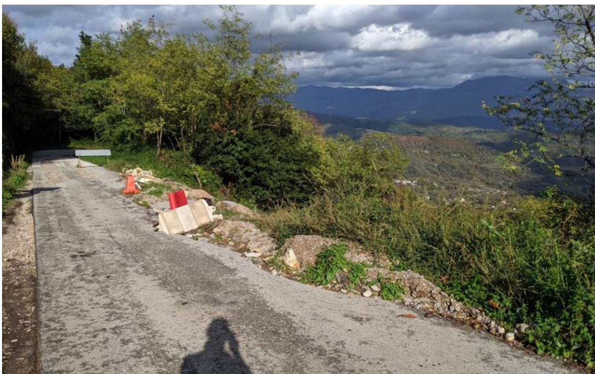
Slika 2.3. Fotografija oštećenja kolničke konstrukcije prometnice nastalog uslijed klizanja te krune klizišta, promatrane od JZ prema SI (fotografirano 4.11.2019).
