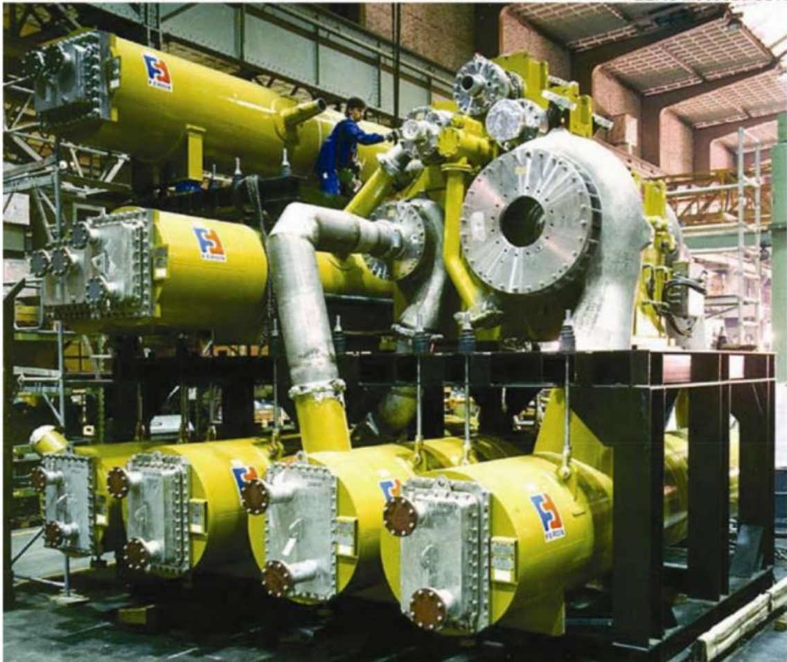
Slika 3-4. 10-stupanjski integrally geared kompresor u Rusiji. (Jensen et al., 2011)
