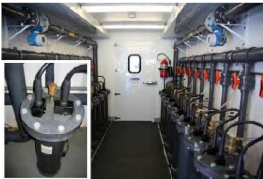
5-1. Elektrokoalescencijske ćelije unutar kontejnera na terenu (Dahm i Chapman, 2014)
