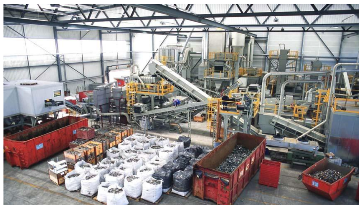
Slika 2 – 3 Pogon za recikliranje elektroničkoga otpada u Švicarskoj (EMPA.CH, 2005.)
