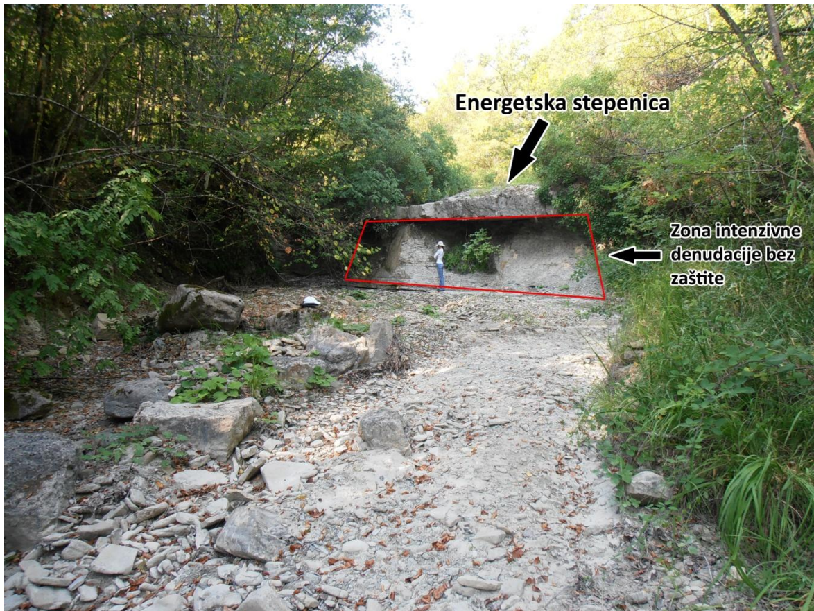
Slika 152 – Nezaštićena energetska stepenica u slivu 9
