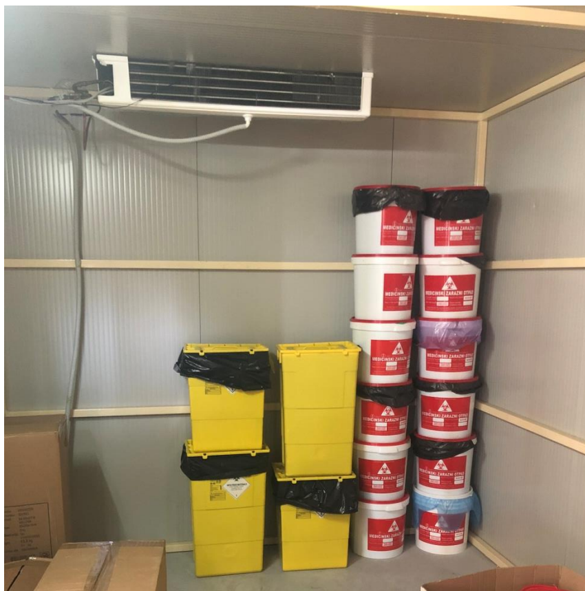
Slika 3-11. Sustav za hlađenje
