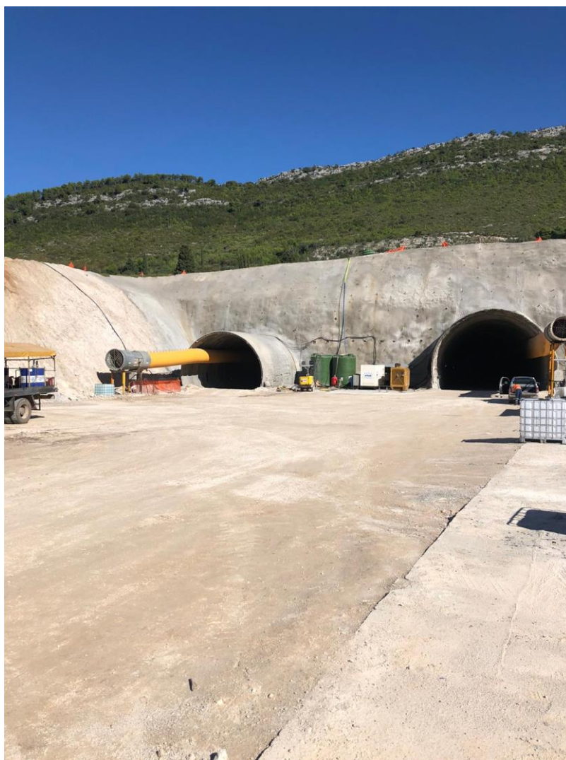
Slika 2.1-1 Ulazni portal s glavnom cijevi (desno) i servisnom cijevi (lijevo) – tunel „Polakovica“
