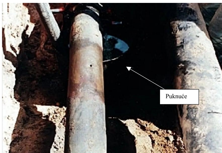
Slika 3-6. Puknuće cjevovoda zbog korozije ( https://www.ogj.com/home/ , 2000)
