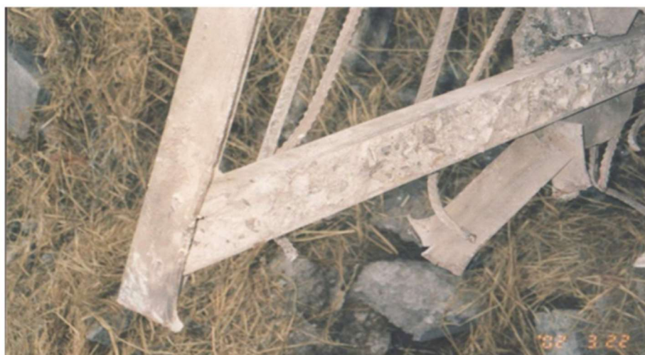
Slika 4-4. Urušena komponenta čelične konstrukcije (Duan et al., 2017)
