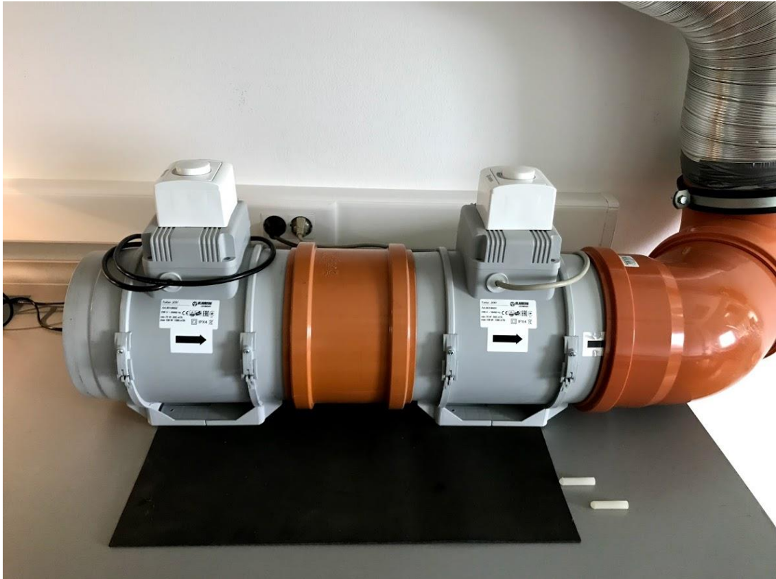
Slika 4-1 Ventilator u laboratoriju
