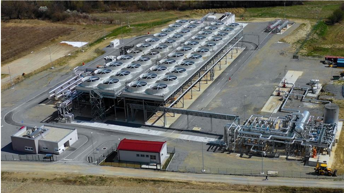
Slika 2-2. Geotermalna elektrana Velika 1 (Gospodarsko interesno udruženje Obnovljivi izvori energije Hrvatske, 2021)
