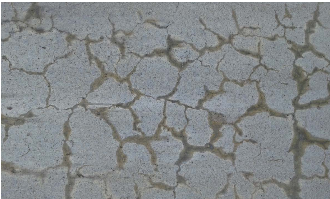
Slika 5. 1 Alkalno–silikatna reakcija u betonu (MIT Concrete Sustainability Hub, 2009).
