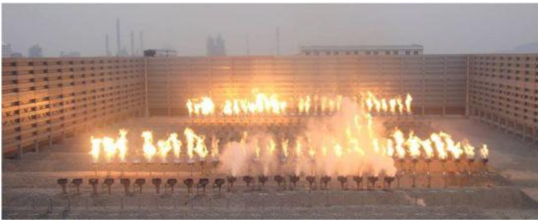
Slika 4-3. Vodoravna baklja s ogradom (Made-in-China, 2022)
