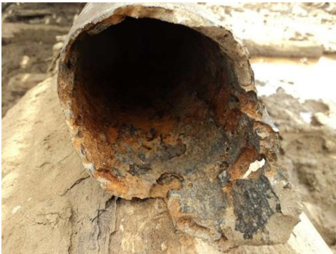
Slika 3-7. \text{H}_2\text{S} korozija ( http://himipex.com )
