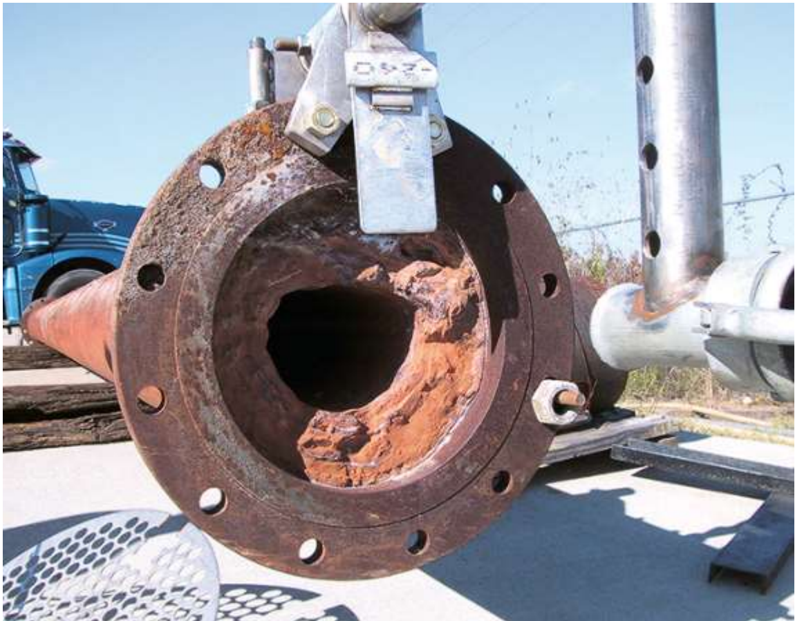
Slika 2-4. Cijev za eksploataciju nafte i plina s naslagama (www.kamat.de)
