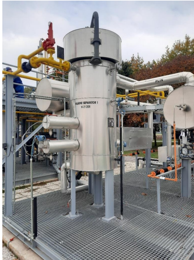
Slika 4-9. Nisko temperaturni separator I
