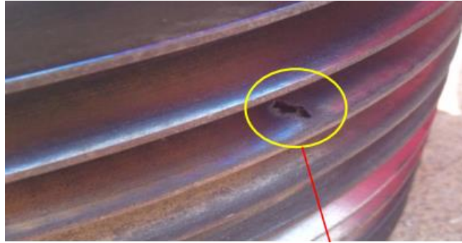
Slika 6-3. Oštećenje utora remenice (Khademi-Zahedi i dr., 2014)
