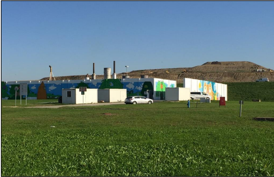
Slika 3-19. Plinsko postrojenje za proizvodnju električne energije na odlagalištu komunalnog otpada „Jakuševac“ (ZAGREBAČKI HOLDING, 2023)
