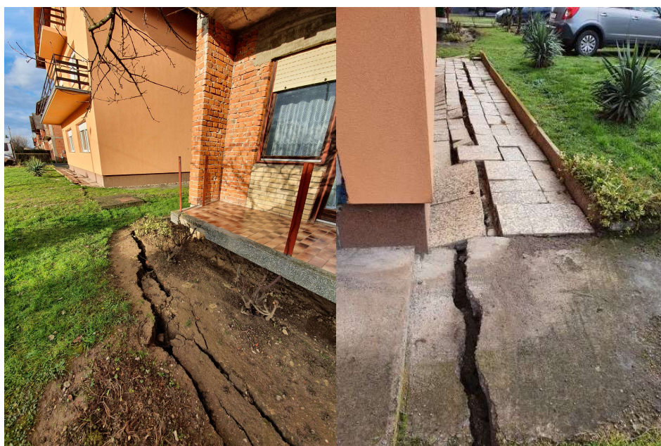
Slika 3-4. Pukotine u blizini objekata (Arhiva: Taus d.o.o., 2021)
